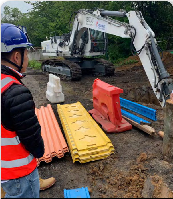
Surface de Stockage réduite sur chantier
